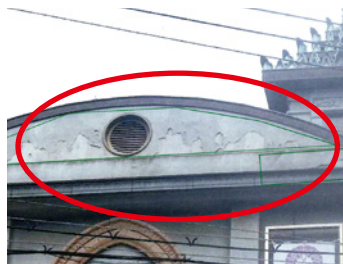
はがれ落ちた外壁
