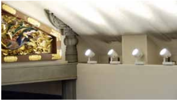
設置したLED照明（本堂右側）
